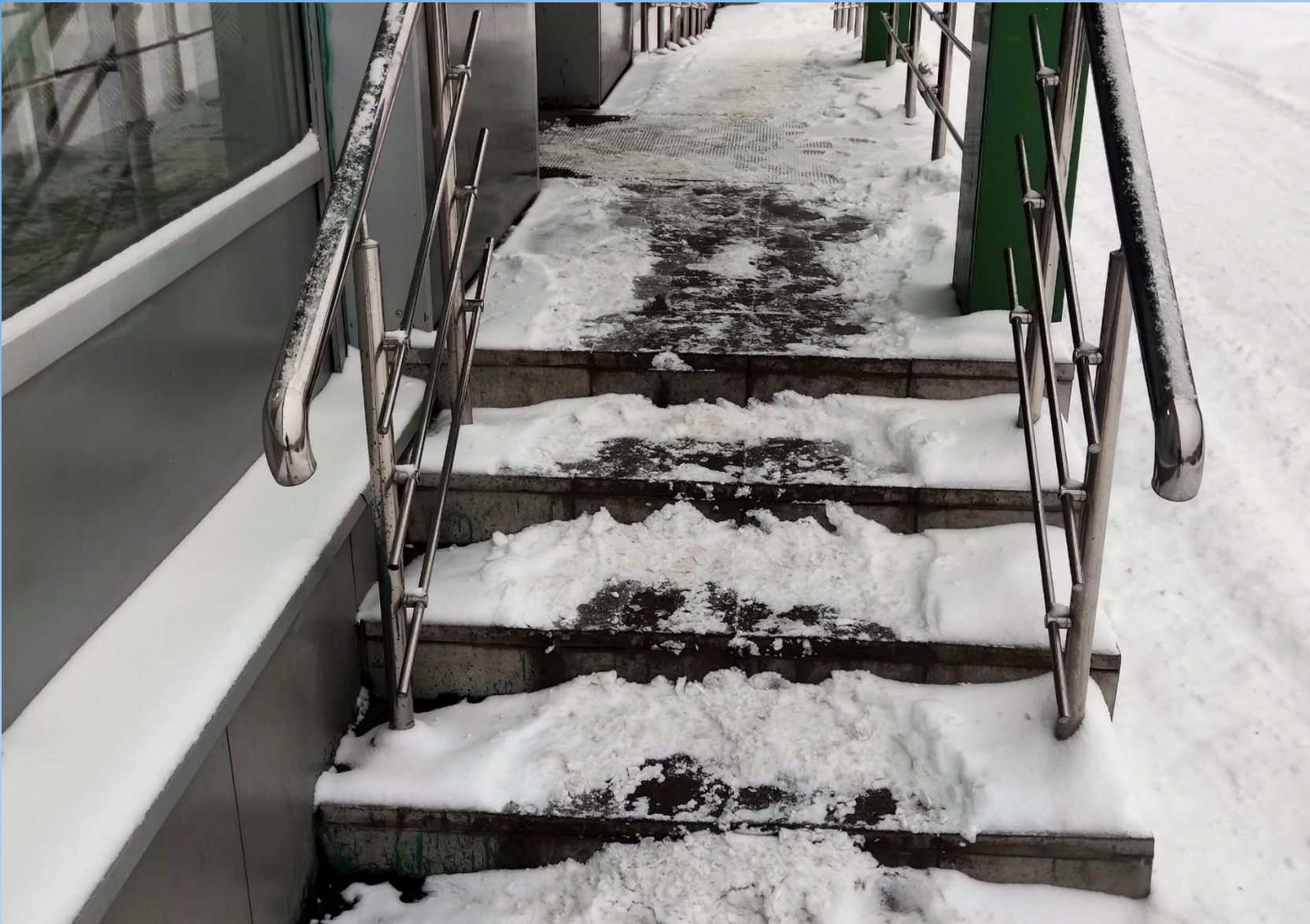
Неочистка входной группы
